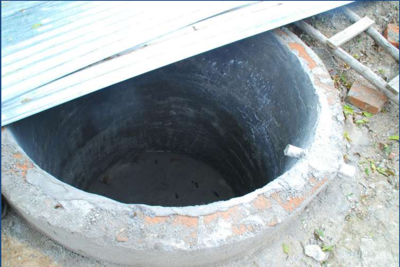
Depósito de agua para bomba EMA
