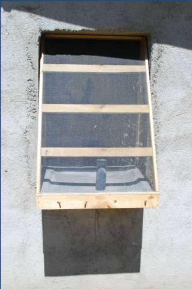
Fregadero y sumidero
